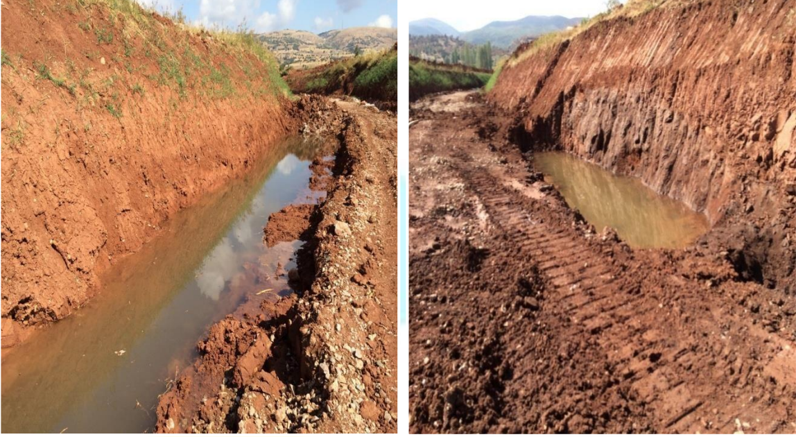
Figür-27,28 Km 241+500 Yeraltı Su Seviyesi.
